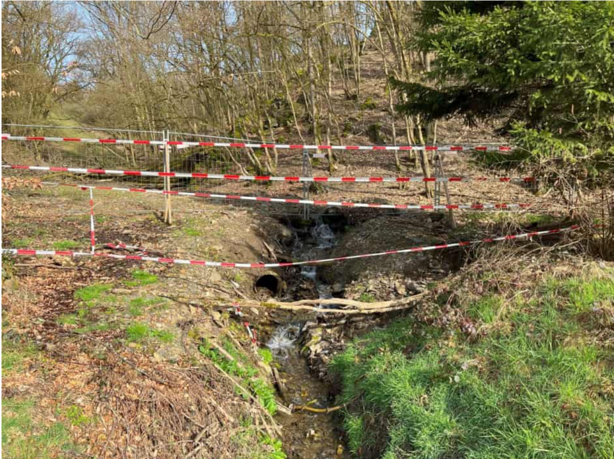
Abbildung 2.13: Beschädigter Durchlass Gossengraben und Zaun Wildtierpark Gackenbach
