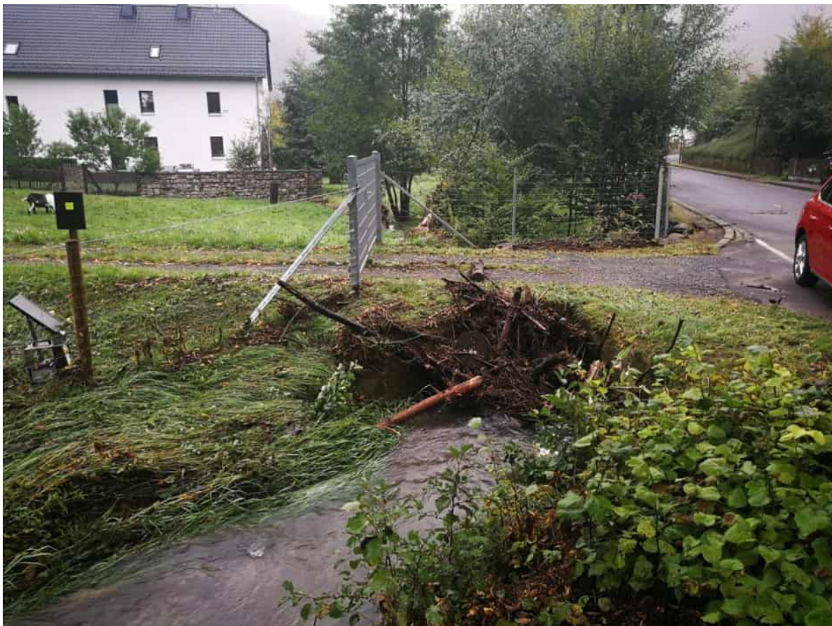
Abbildung 2.5: Verklauter Durchlass Seelbach in Dies nach Starkregen
