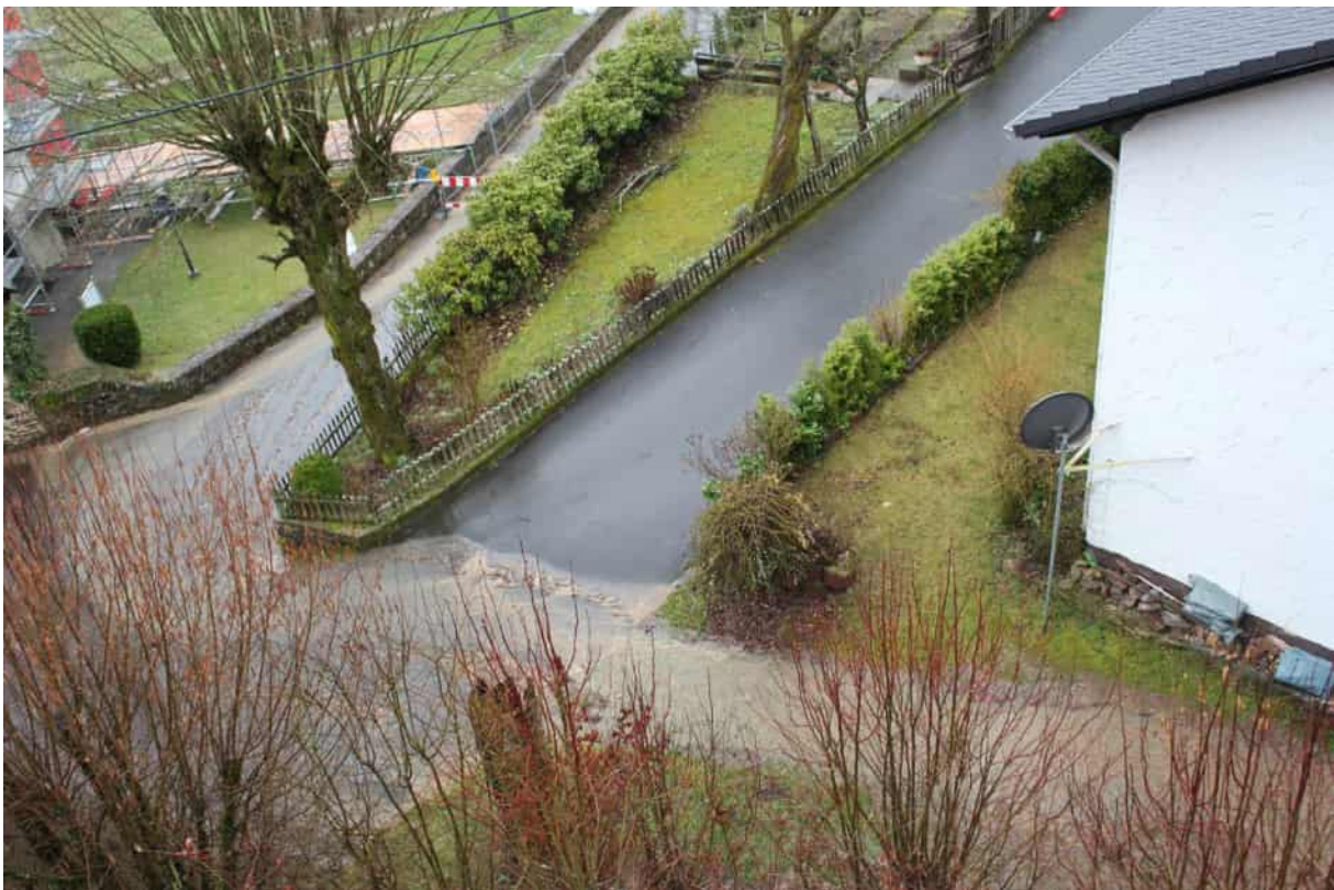
Abbildung 2.8: Übergelaufenes Einlaufbauwerk Kirchährer Bach in Kirchähr
