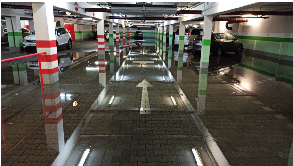
Abbildung 14: Überflutung der Tiefgarage Altstadt I am 17. Juni 2020 (J. Klinger)
